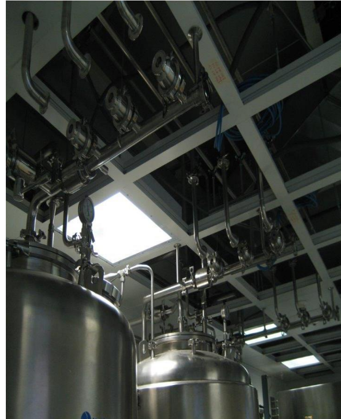
Serbatoi e collegamento a impianto
